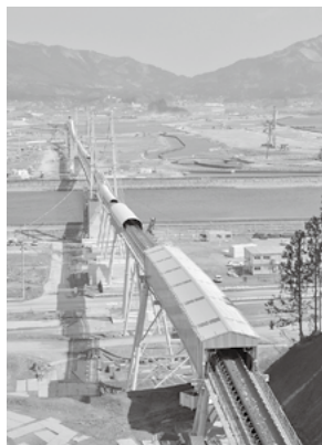
土砂運搬ベルトコンベア
