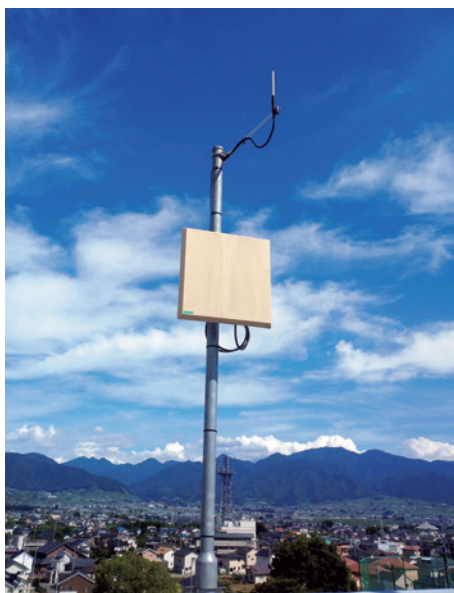
市役所屋上に設置した 基地局
